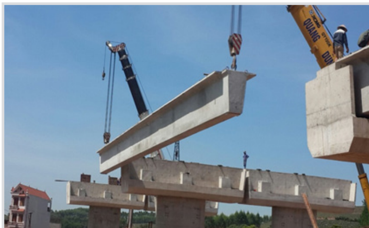
Thi công lắp đặt dầm Super T bằng phương pháp đấu cầu
