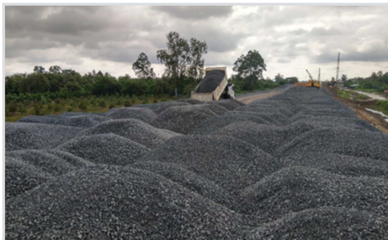
↖ Đắp lớp vật liệu gia tải không đúng theo phân lớp và tốc độ đắp
