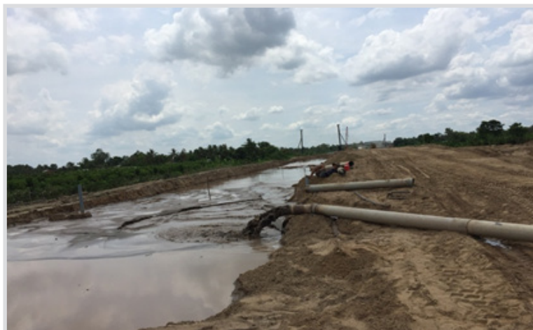
❖ Thi công đắp nền đường không đúng định kỹ thuật (bơm cát trực tiếp)
