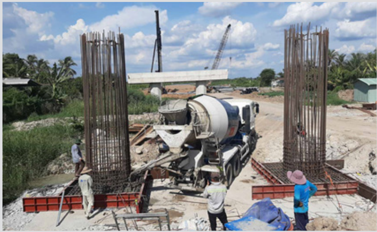
⚡ Thi công cốt thép thân trụ sai vị trí phải đập đi làm lại
